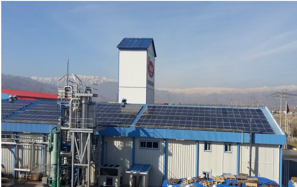
Ekonomik Yatırımların Desteklenmesi. Meyve İşleme Tesisi Alternatif Enerji (Güneş Enerjisi) Üretim Projesi
